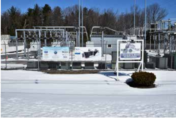
Massachusetts es uno de varios estados que han implementado políticas para estimular el desarrollo del almacenamiento de energía. Arriba, la primera instalación de almacenamiento energético a escala masiva del estado en la ciudad de Sterling, esta instalación almacena electricidad proveniente de una matriz de paneles solares en el sitio.
